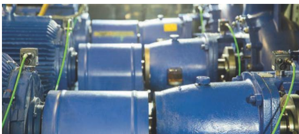
Nadzór ciągły silnika i pompy
